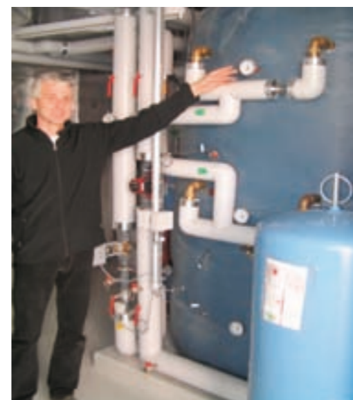
Franz Landolt vor dem grossen Boiler, der durch Sonnenenergie und Erdgas aufgeheizt wird.
