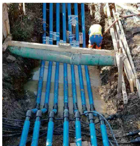
Gefragte Energie: Unter der Erde finden sich viele Gasteilungen der Energie Zürichsee Linth.
